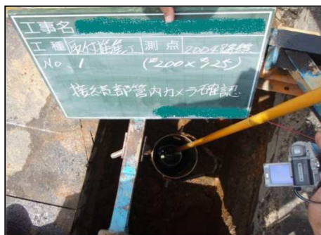
9・取付管接続後、山留め管内部にカメラを挿入する状況を撮影します。
